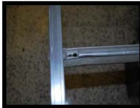
Perforación en peldaño Cambiar escalera
