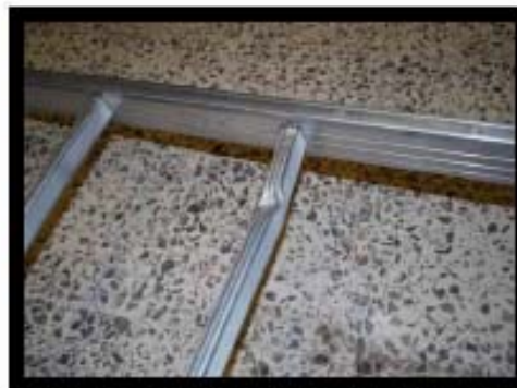
Golpe que no impide el buen funcionamiento de la escalera
