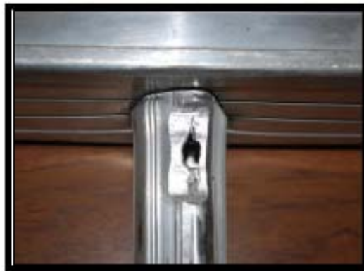
Peldaño en malas condiciones por desgaste excesivo Cambiar escalera
